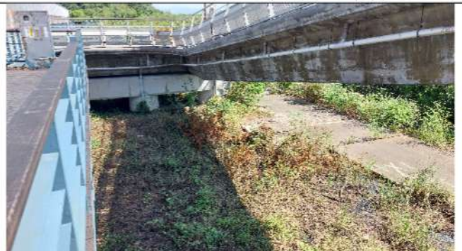
關渡橋自行車牽引道高架棧橋下方積水 形成草澤環境
